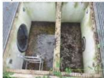
Clapet de confinement et orifice calibré
