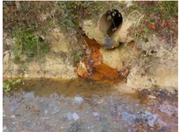
Macro-déchets et traces d'irisations en aval du DSH2 dans le BR n°4
