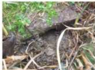
Collecteur de fuite obstrué
