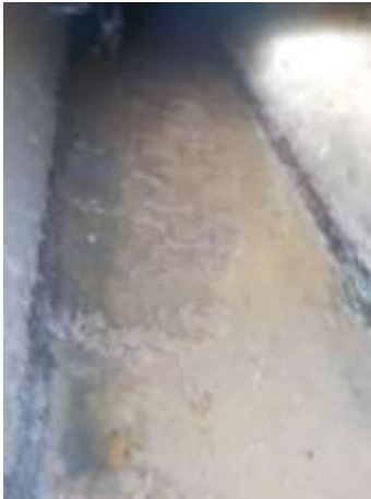
Écoulements d'eaux usées en amont du BR 2
