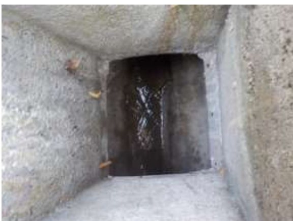
Écoulement d'eaux usées rue de Villevigne
